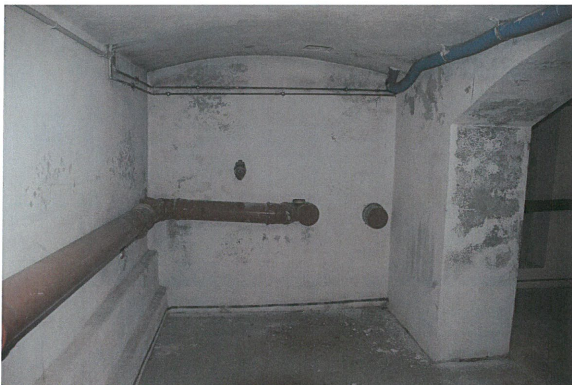
Fot. 4. Zawilgocone ściany w pomieszczeniu 0.1 piwnic.
