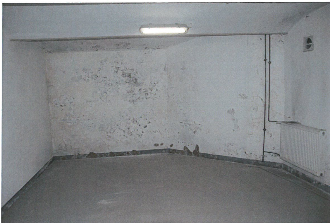
Fot. 6. Ściany w pomieszczeniu 0.4.
