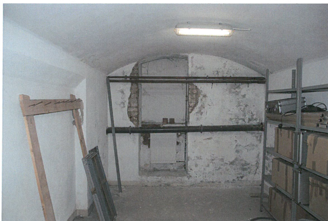
Fot. 9. Pomieszczenie 0.2 – destrukcja w obrębie ścian zewnętrznych.
