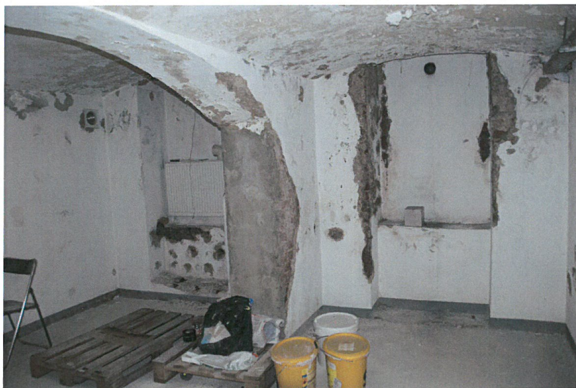
Fot. 7. Destrukcja tynków na ścianach i sklepieniach w pomieszczeniu 0.5.
