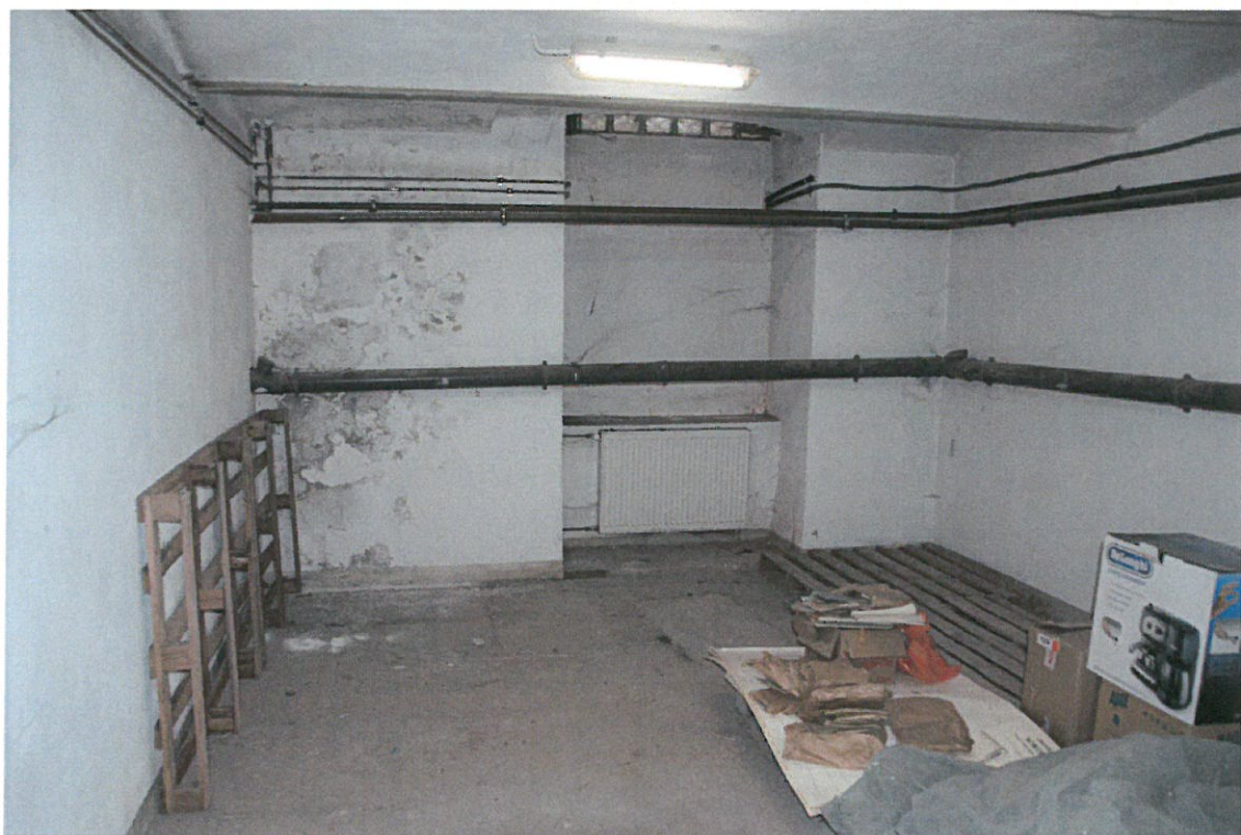
Fot. 8. Zawilgocenie tynków w pomieszczeniu 0.3.
